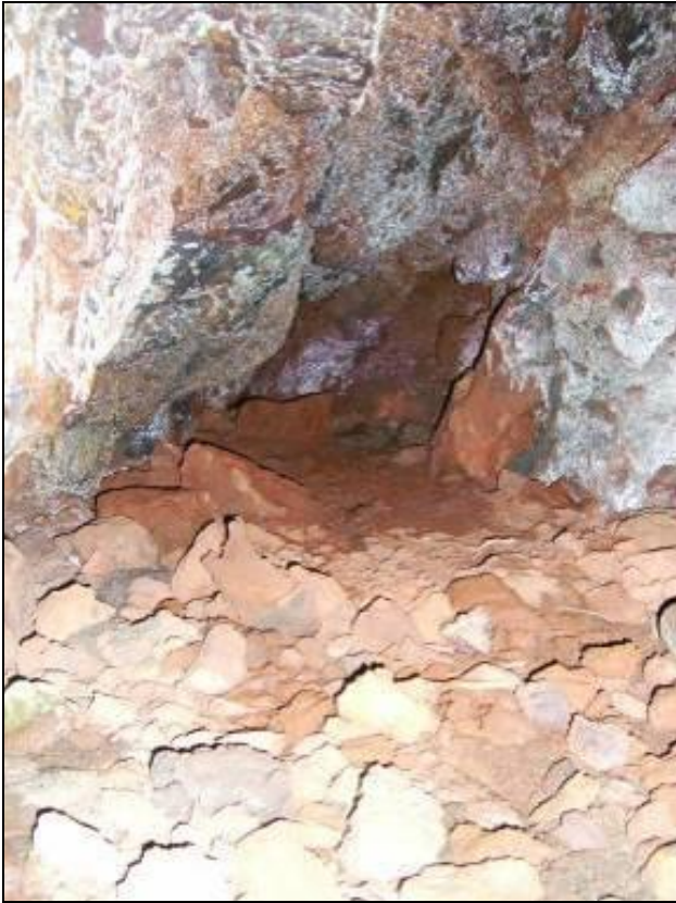
Figura 25: Canalículo no final da CV 05, com aporte de sedimentos finos para o interior do conduto.
