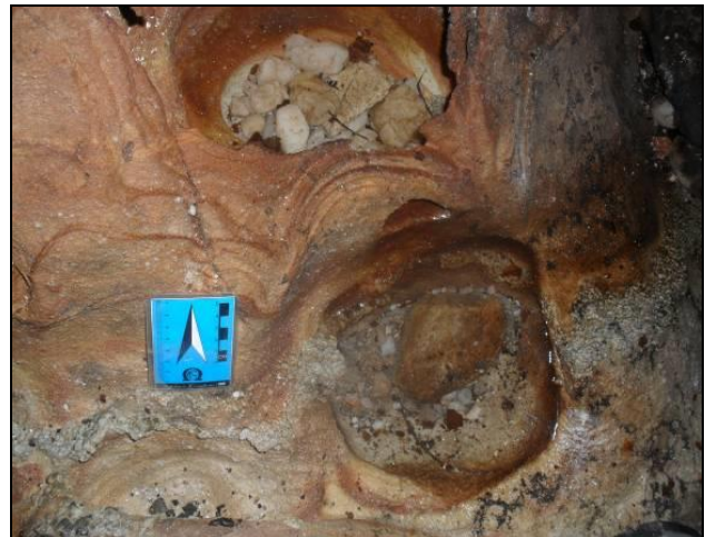
Figura 20: Panelas formadas por gotejamento localizado na CV 8/9/16.
