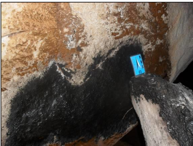
Figura 34: Crosta de cor preta na parede da CV 8/9/16.
