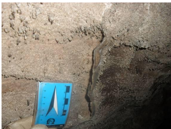
Foto 31: Cortina no conduto principal da CV 8/9/16.
