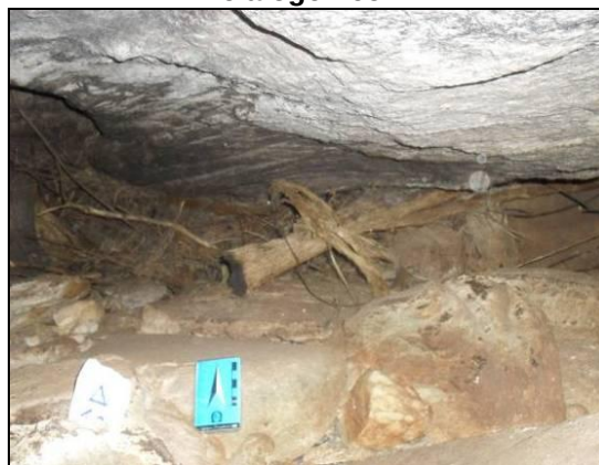
Foto 92: Galhos e sedimentos carregados por água pluvial.
