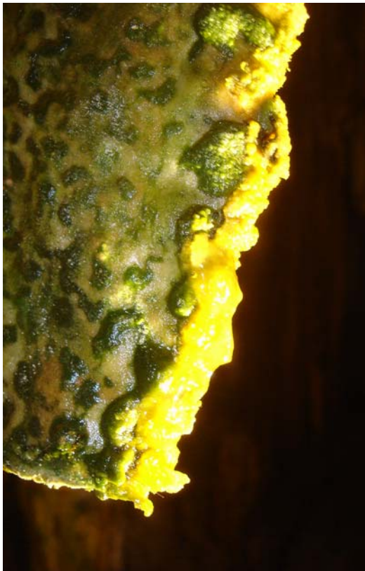
Foto N. 09 – Se há escorrimento de água (como nas bordas de uma cortina) ou a superfície é molhada, a presença da iluminação induz ao desenvolvimento de esporos e em pouco tempo a formação, que era branca, fica toda verde com a clorofila produzida.
