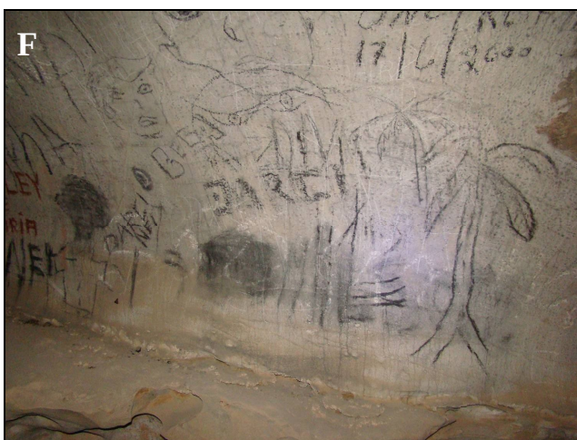
F) Pichações no interior da cavidade;
