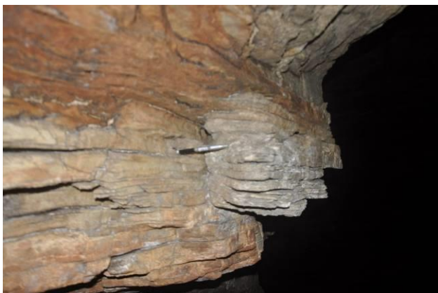
Figura 11: Acamamento do quartzito grosso mostrando aberturas maiores que 5mm.
