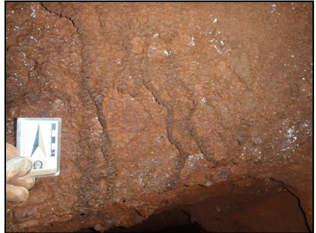
Figura 6: Escorrimento ferruginoso na parede com formação de microtravertinos na superfície do escorrimento.
