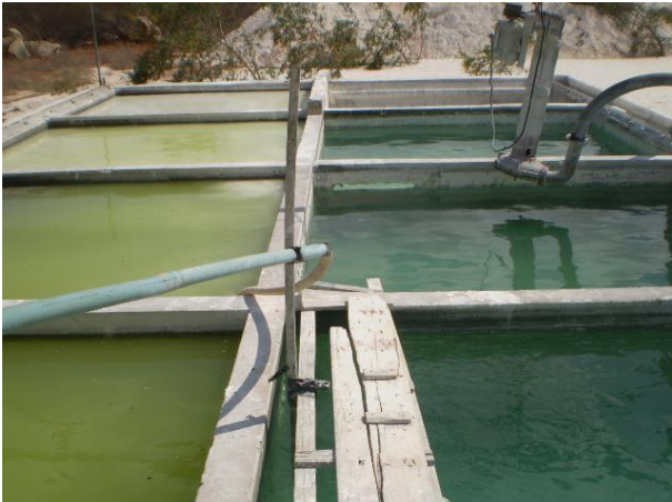
Figura 11: Efluente do beneficiamento com tratamento em circuito fechado.
